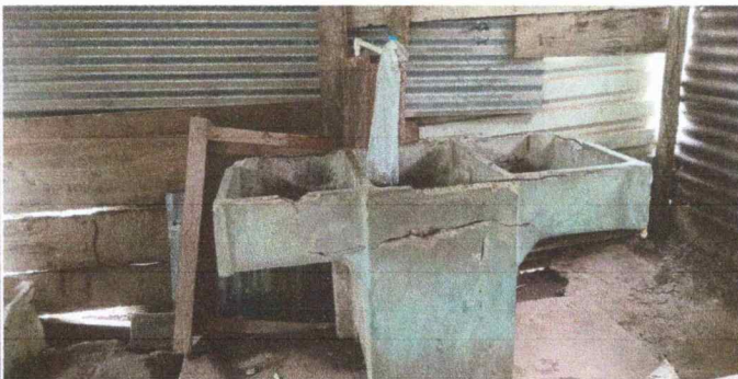
Foto 3: Se observa la pila de cemento de dos lavadero en mal estado.
