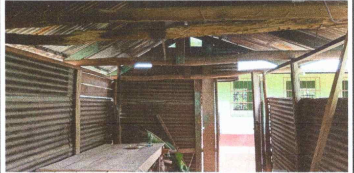
Foto 2: Se observa la estructura interior del edificio en mal estado.
